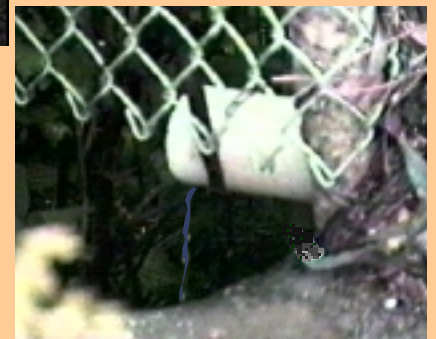
Tubería interna de descarga del sistema CRAM en palos verdes Drive South.
