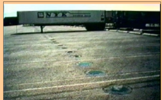
Deformaciones en el pavimento convencional de la terminal NYK en el Puerto de L. A. causadas por los chasis.
