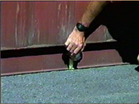
El pavimento CRAM en el Puerto de L.A. muestra deformaciones típicas de 1/4" ó menos en el paso de las ruedas de los montacargas....
